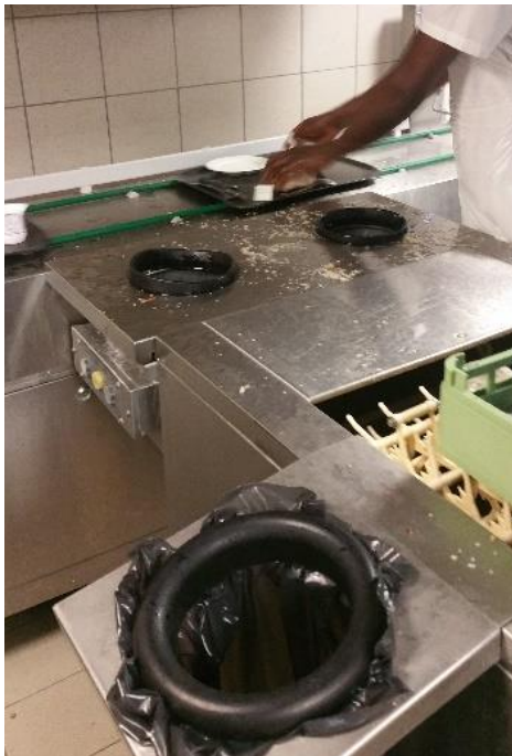
Collecteur installé sous les gouttes de tri :
